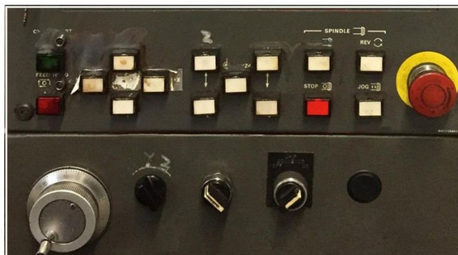
تصویر ۶. تصویری از یک کنترل پنل صنعتی حاوی پیش‌خوردهای نادرست و مخفی (مأخذ: نگارنده)
